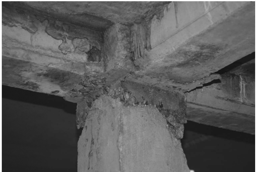
Illustration 2 : exemple de réalisation en béton armé bâclée en travaux neufs, avant livraison au maître d'ouvrage.
