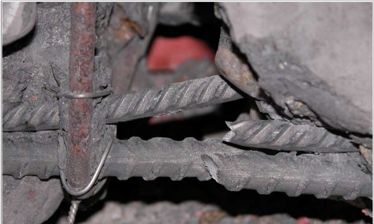
Illustration 11 : rupture en traction des aciers tendus en partie inférieure d'une poutre fléchée
